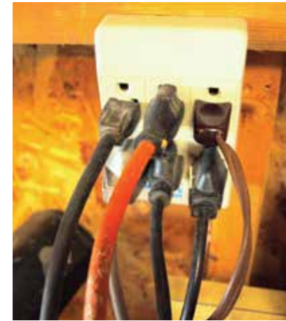
Evite sobrecargar los enchufes con adaptadores y demasiados enchufes con electrodomésticos.
